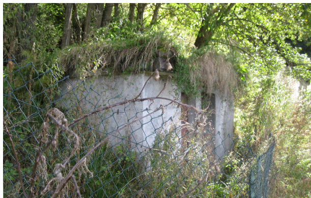
Vasca punto di partenza dell'acquedotto
