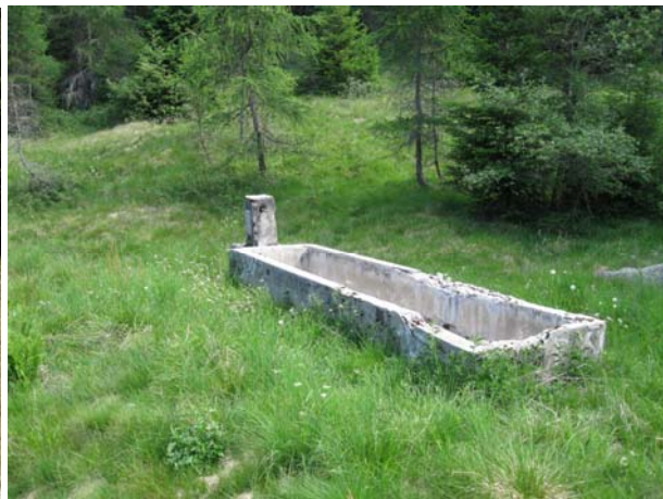
Tratto terminale dell'acquedotto AIB
