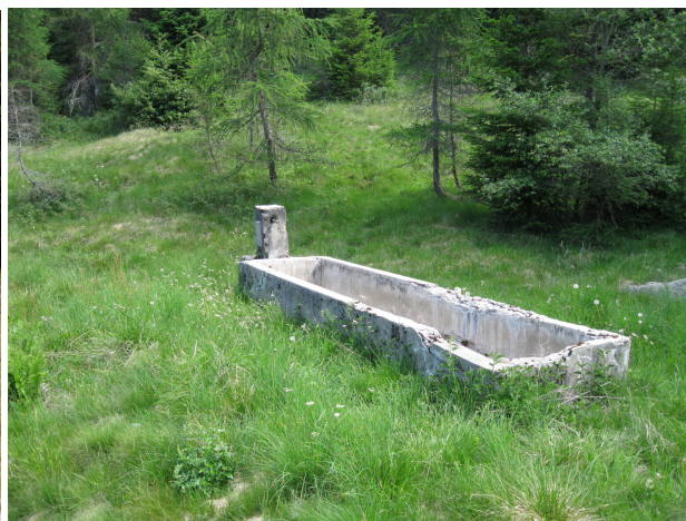
Tratto terminale dell'acquedotto AIB
