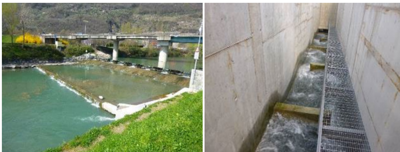
FIGURA 19. LA TRAVERSA A SERVIZIO DELLA CENTRALE IDROELETTRICA IN-FLOW "LE BOSCHE DI GIANICO" (SINISTRA) CON IL PASSAGGIO PER PESCI (DESTRA).
